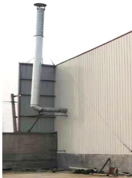
布袋除尘设备+15 米排气筒
