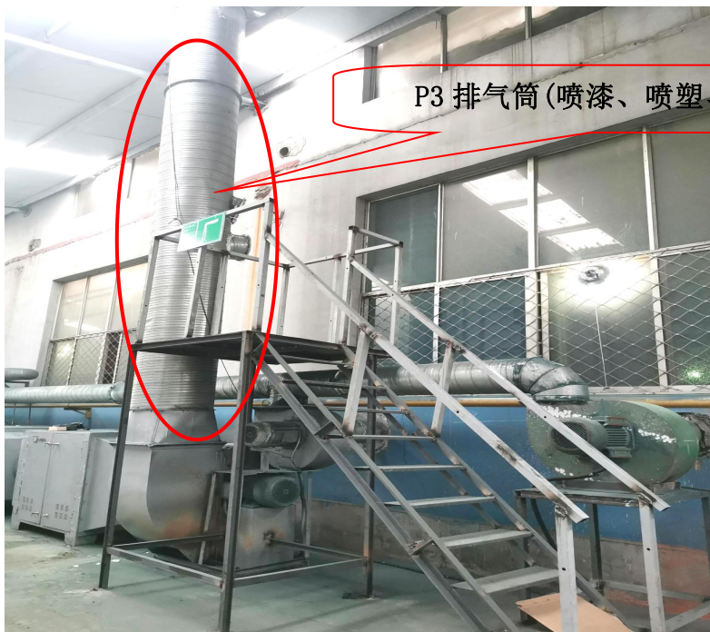
排气筒 P3 喷漆、喷塑、烘干（喷塑固化、电泳烘干）
