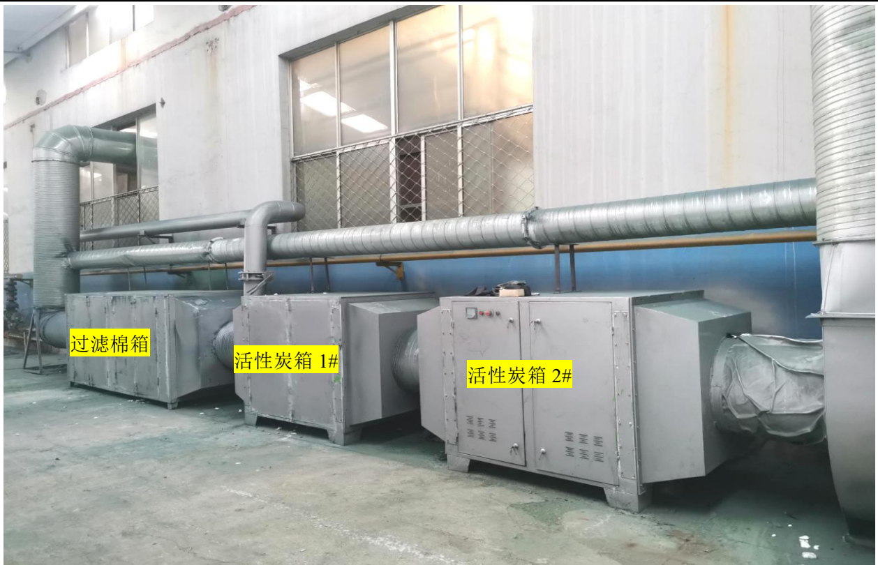
过滤棉箱+活性炭箱 1#+活性炭箱 2#
