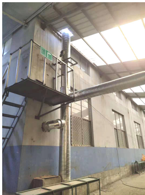
抛丸、天然气燃烧废气排气筒 P2
