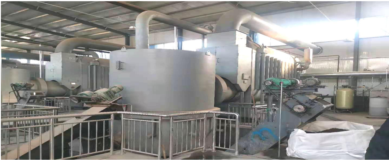
生物质燃烧机+真空热水机组
