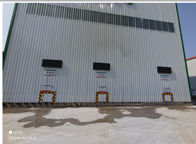
水泥及粉煤灰上料口
