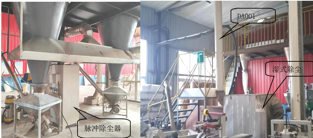
固态肥废气排气筒 DA001
