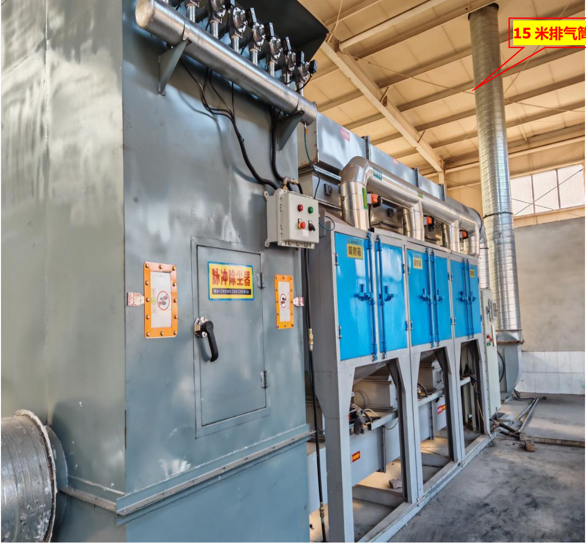
布袋除尘器+活性炭吸附脱附催化燃烧+15 米排气筒
