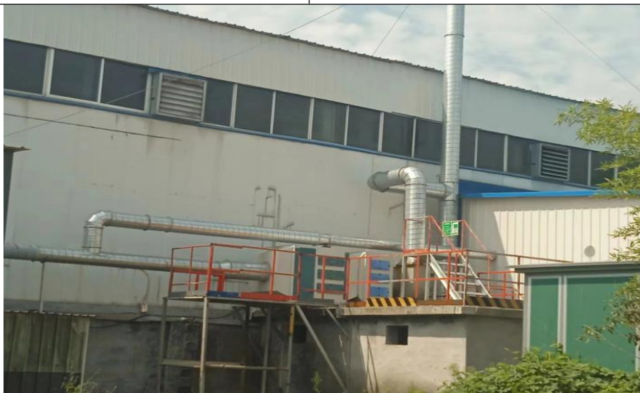
两级活性炭吸附装置+排气筒 DA003
